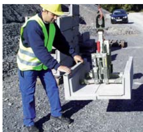
Kábelcsatorna lerakó KKV
